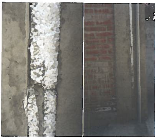
Foto N° 1 y 2 – Junta de dilatación en esquina de muro medianero.
